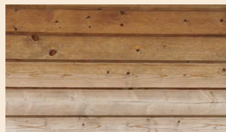
Väggen på en trädgårdstuga som impregnerats brun och som har stått utomhus i fyra år utan ytterligare efterbehandling. Den del som utsatts för solen är kraftigt blekt.
