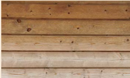
Puutarhamökin seinä, joka on ruskeaksi kyllästetty ja seisonut ulkona neljä vuotta ilman lisäkäsittelyä. Aurinkoiselle puolelle altistunut osa on voimakkaasti haalistunut.
